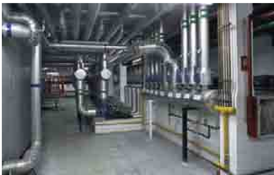
Una sección de la sala de máquinas alojada en uno de los sótanos de la parte central del conjunto.
